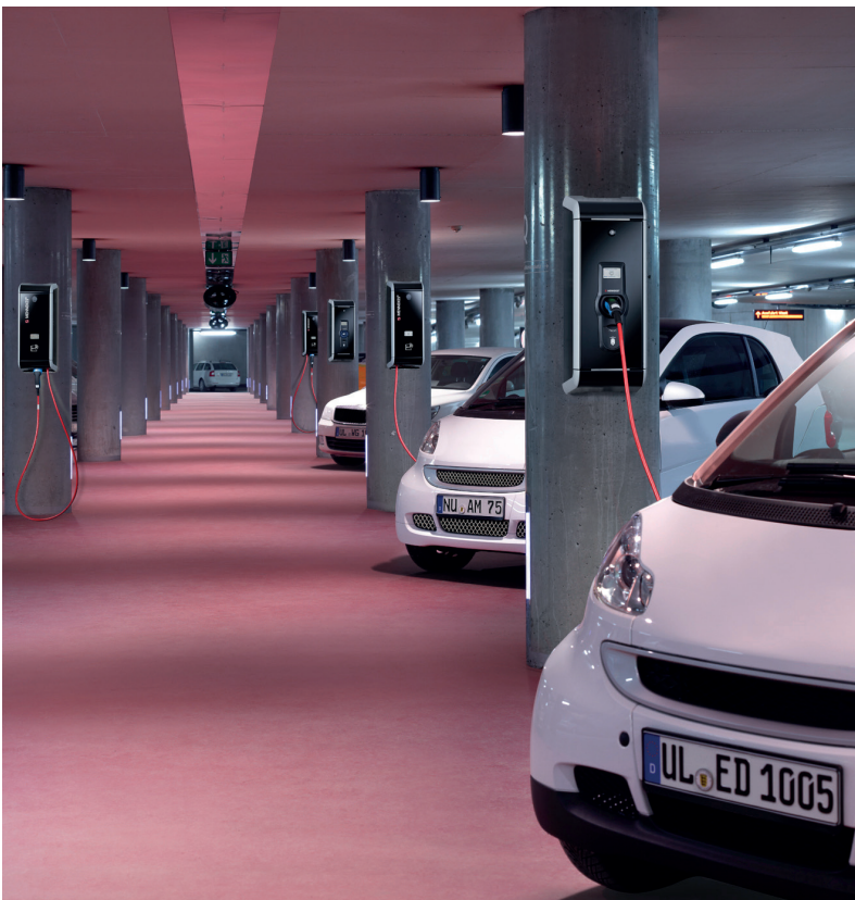
Bild 9: Ladeeinrichtungen für Elektrofahrzeuge in einer Tiefgarage
