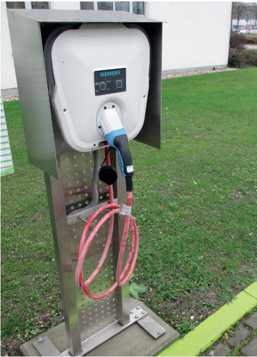
Bild 12: Ladestation im Außenbereich mit Regendach
