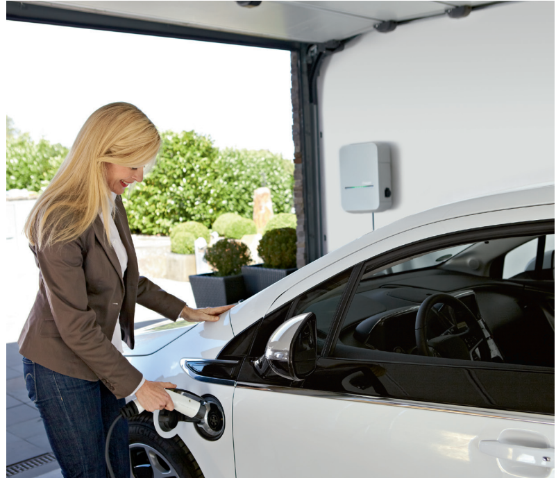
Bild 13: Ladestation in einer Garage
