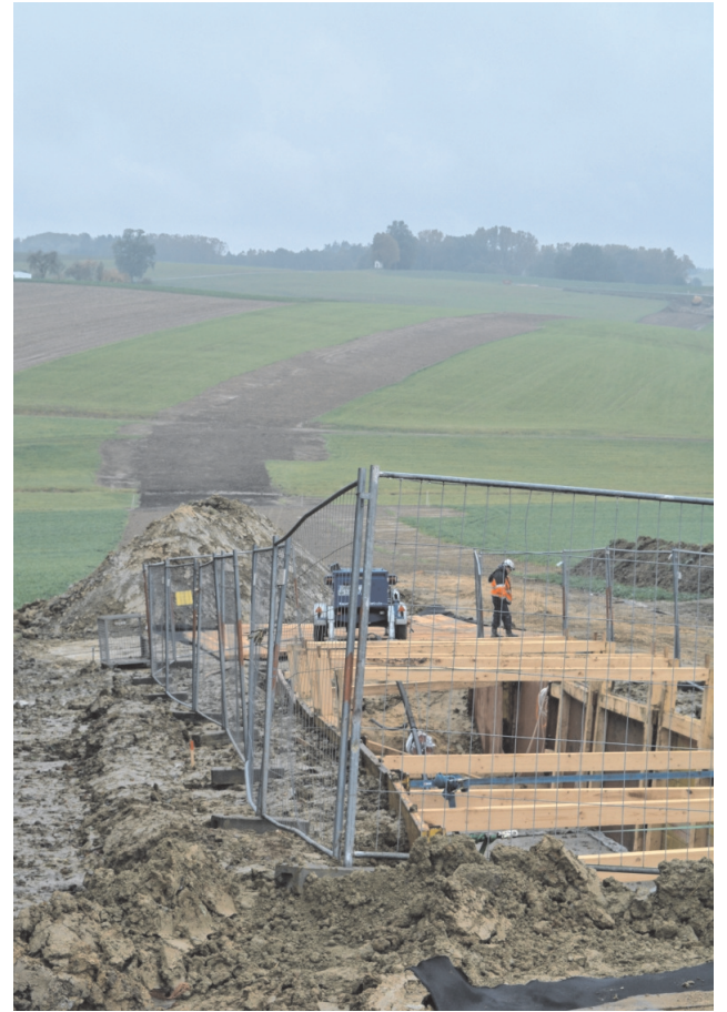
Wie ein braunes Band zieht sich die unterirdische Stromtrasse über die landwirtschaftliche Fläche. Doch davon wird im nächsten Jahr nichts mehr zu sehen sein.
